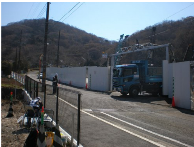
図 3.3-1 実施区域北側敷地境界と実施区域出入りゲートの状況
